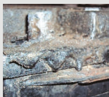
QUEMADA Por exceso de calentamiento en el motor.
