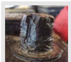
EXCESO DE SUJECIÓN Por terminales demasiado apretadas.
