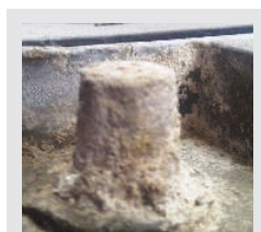
SULFATADO Ocasionado por un golpe.
